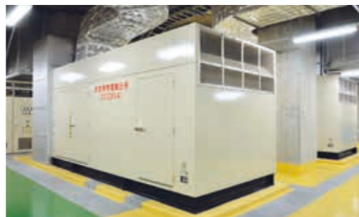
非常用発電機 Emergency Power Generator
